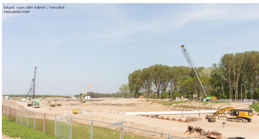
Aanleg van de tunnelbak van de Blankenburgtunnel, waardoor de druk op het landschap van Voorne en Goeree groter zal worden. Foto: Mark van der Meer.
